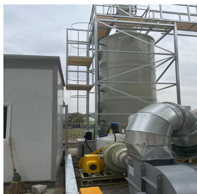
碱液喷淋处理装置
