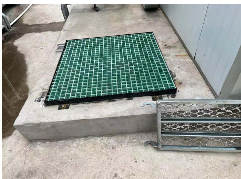
调节池（皆做应急池）
