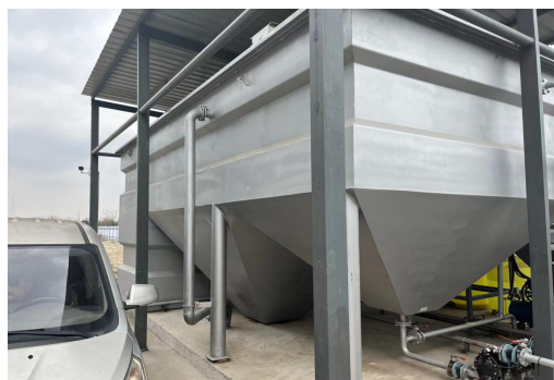
废水处理设施
